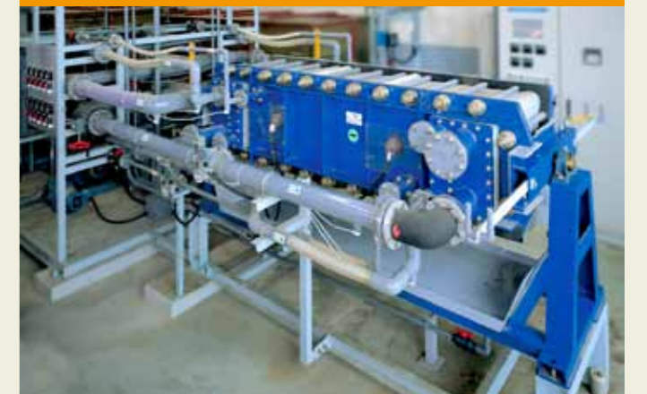
工程排水脱塩 DB-4型 電気透析槽 (320対) / 770m 2 DB-4 electro dialyzer (320 cell pairs) / 770m 2
